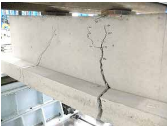
写真5 破壊状況（裏側） 試験体記号：No.2 P_{max}=323 kN ・コンクリートの曲げ割れ及び圧壊
